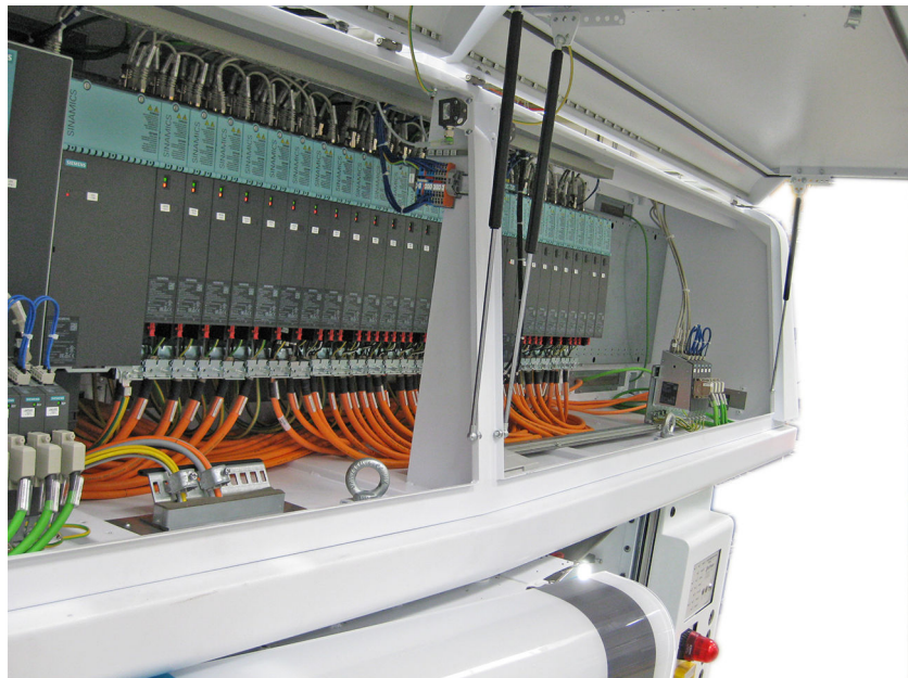
Exemple : Portes des armoires électriques d'un multibroche
